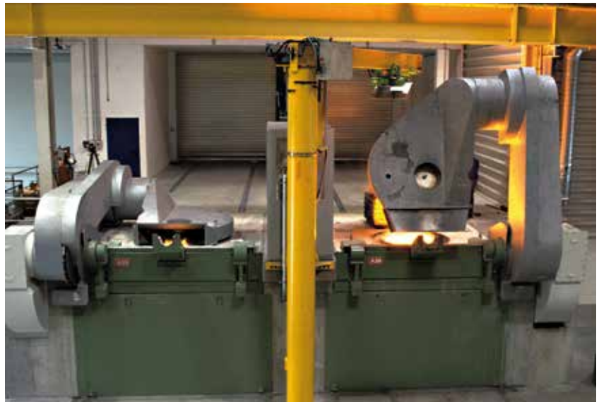
Bild 9: MF-Tiegelofen-Tandem, bestehend aus zwei 12-t-Öfen mit einer 8400-kW-Twin-Power-Energieversorgung [7].
